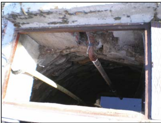
15. Detalle del pozo excavado (punto de agua nº 6 en la Figura 2). Fotografía tomada el 28 de marzo 2012.
